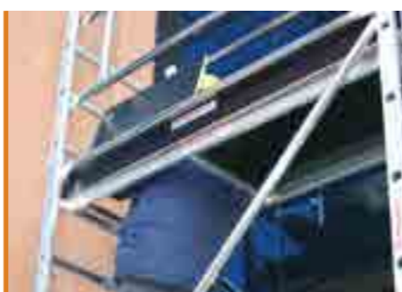
Con l'uso della botola si sale in sicurezza. Use the trapdoor to go up safer.
