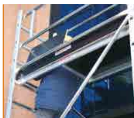
Con l'uso della botola si sale in sicurezza. Use the trapdoor to go up safer.
